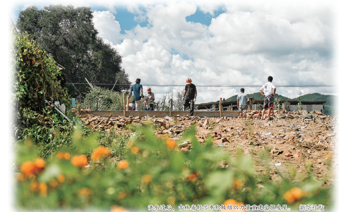
洪水过后,吉林省舒兰市积极组织力量重建受损房屋。新华社发
