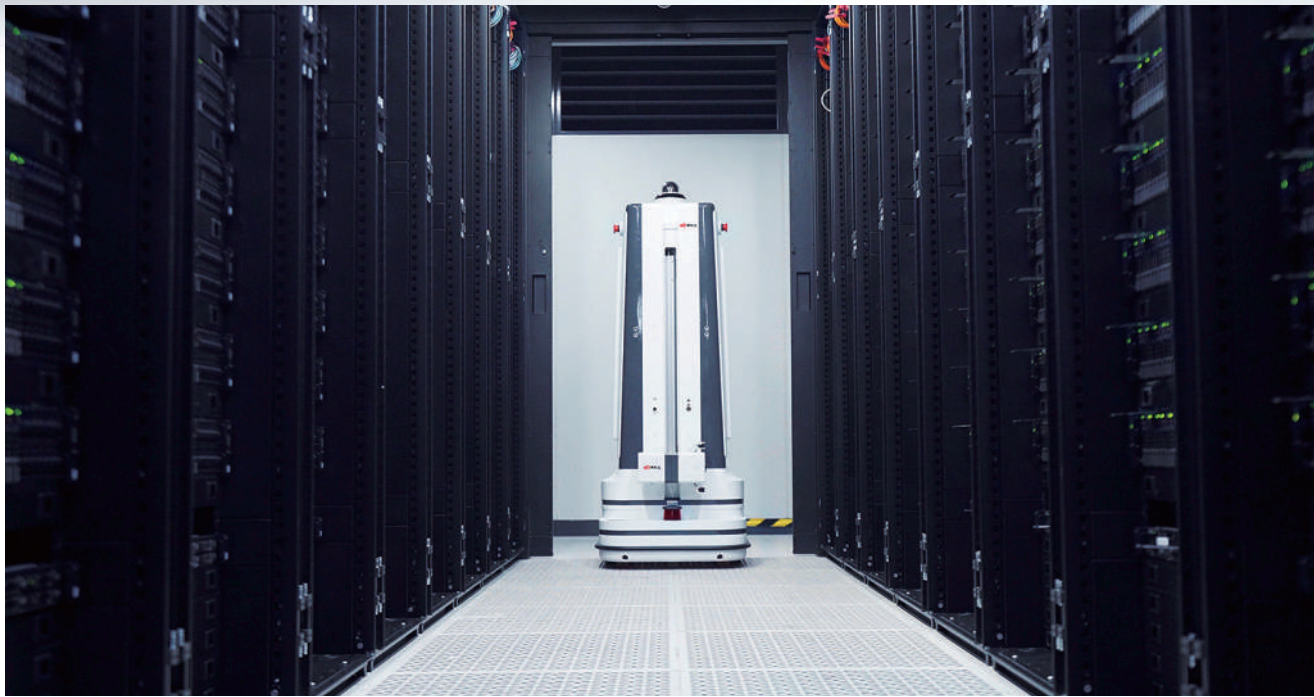
京东云数据中心内智能巡检机器人在工作
