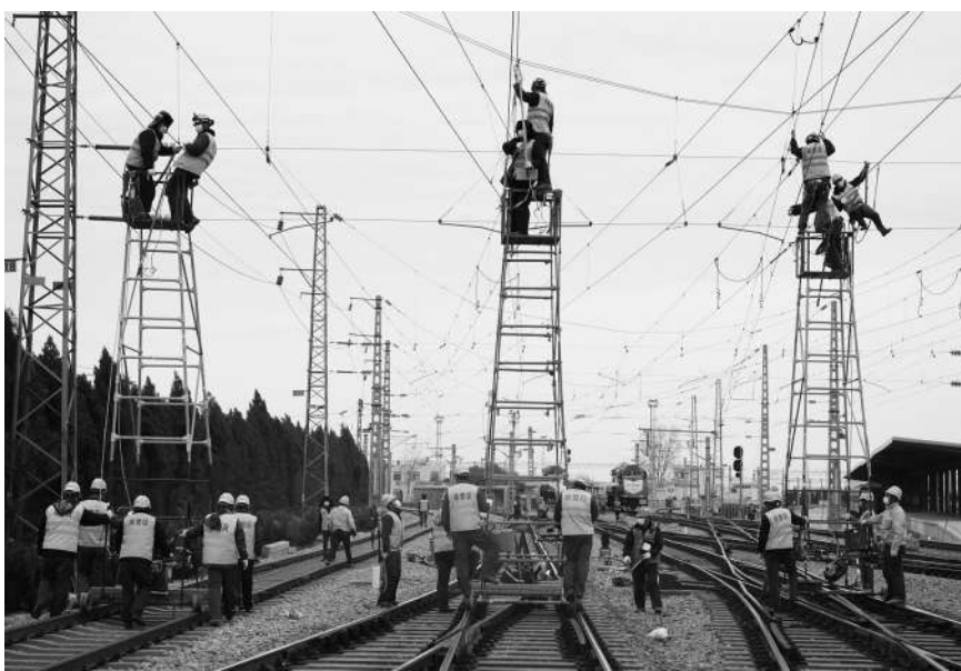
近日，中国中铁电气化局运营公司济南维保处所属各设备进行一次“零距离、地毯式”检修“问诊”，全面提升铁路供电设备运行质量，确保铁路运行畅通。崔顺利 摄
